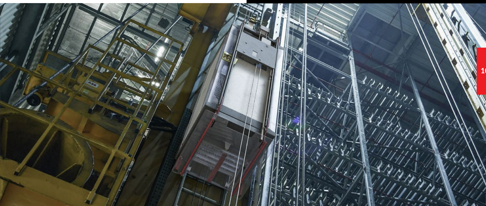
Hochregallager (Frankfurt), TOPlift, 40 m Fahrstrecke
